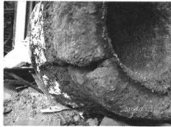
图4 浸渍管开裂情况
